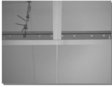
Alinhe o segundo cabo-guia com o primeiro perfil T secundário de 1250mm
